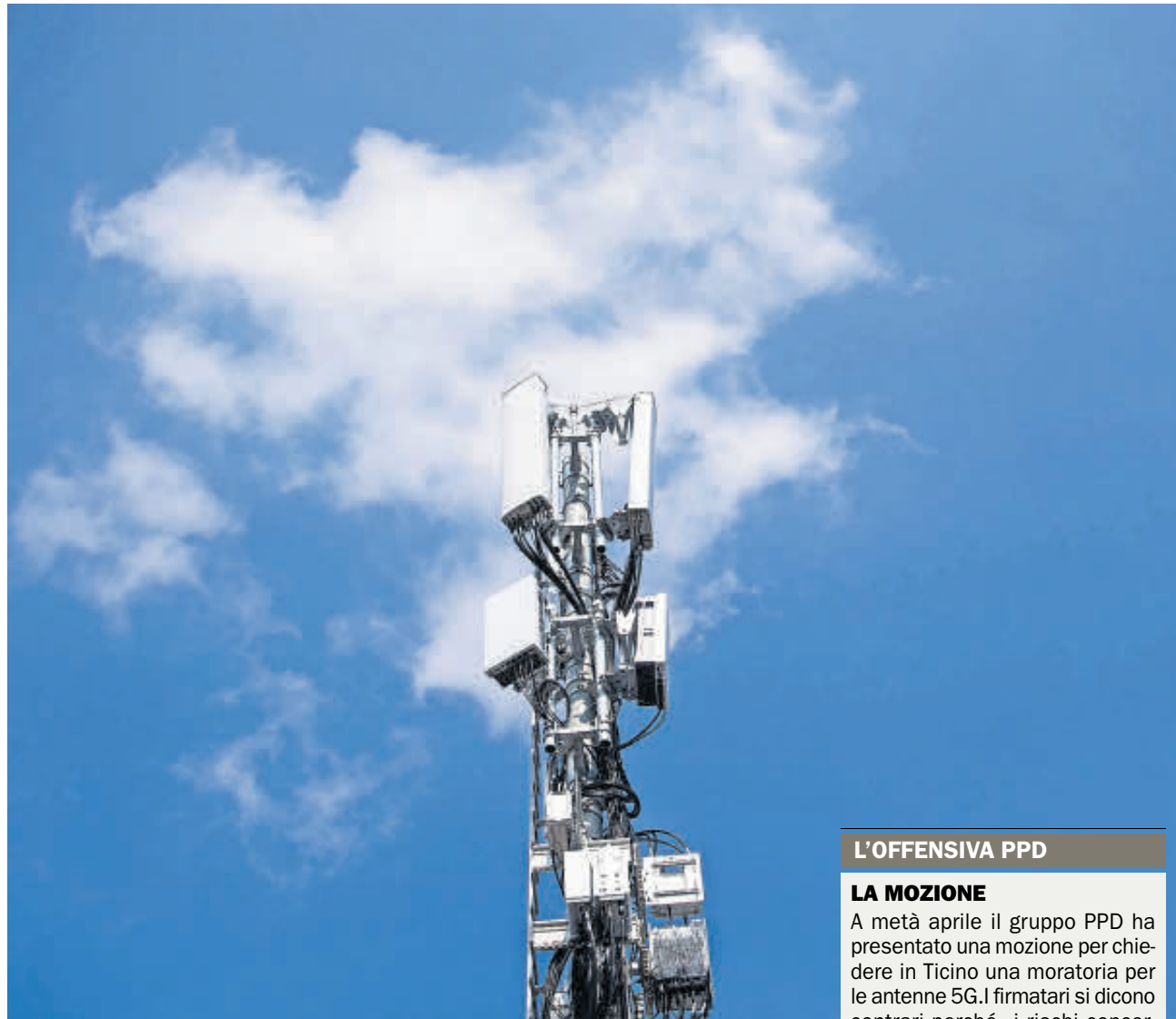
LA NUOVA TECNOLOGIA Ecco un'antenna di telefonia mobile posata recentemente a Berna. (Foto Putzu)
